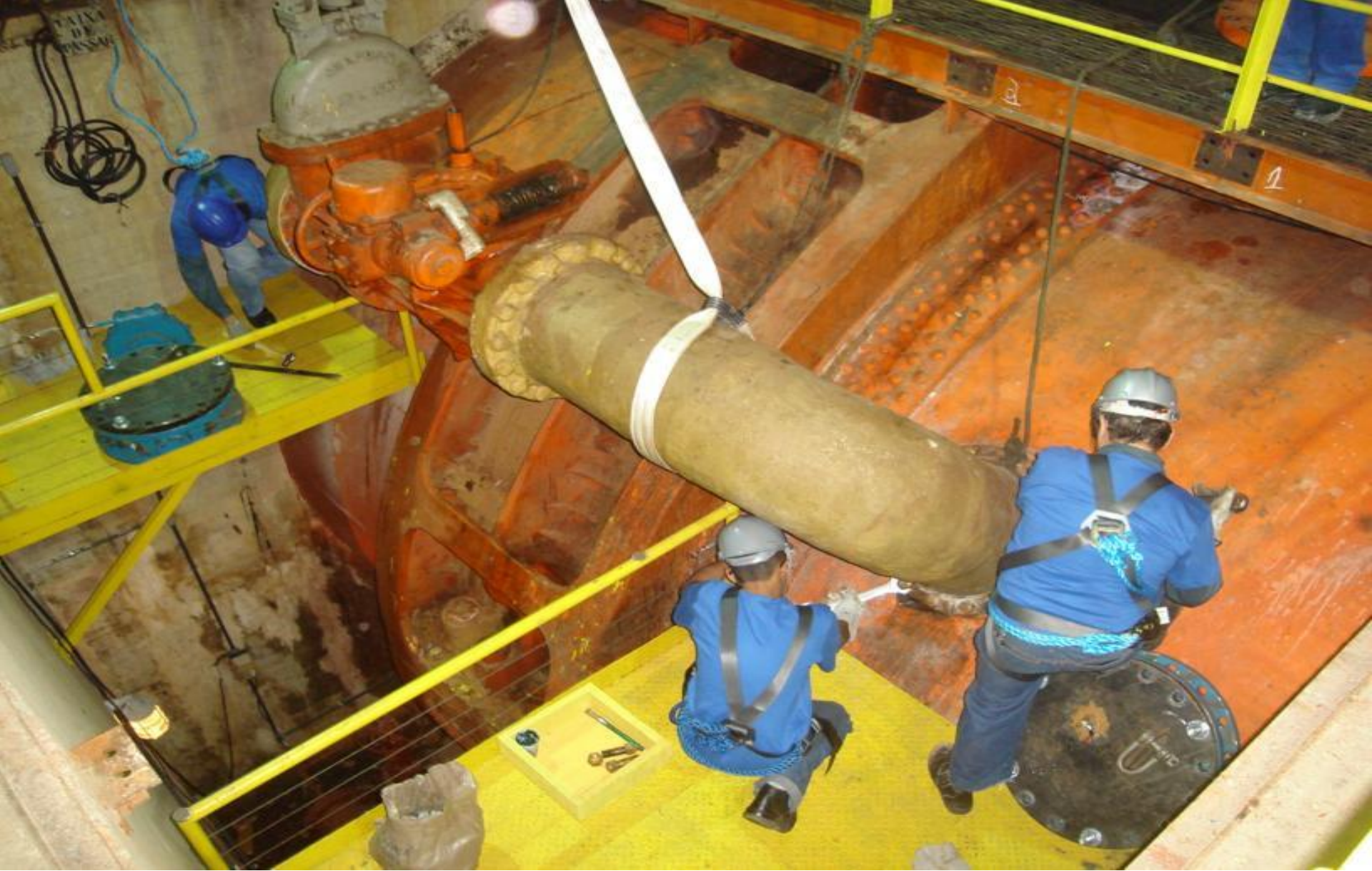
Câmara de Válvulas
