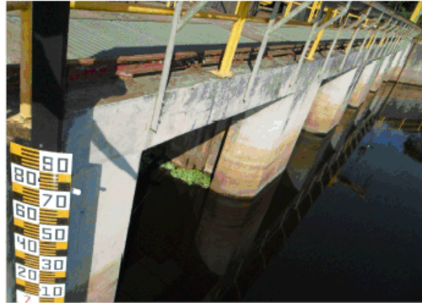
Fig. 3. Detalhe da entrada dos poços de sucção
